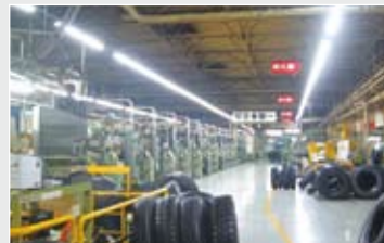
■ 蛍光灯の配置変更と併せて省エネ型を導入し、照明電力を削減
